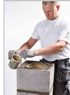
Armeerimiseks vala nurga-avadesse Weber Jootebetooni 600/3 ning lükka armatuurvarras (8 mm) auku. Vajadusel vala jootebetooni juurde. Jälgi, et jootebetoon kuskilt ei lekiks.
